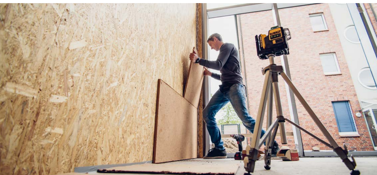
Passionierter Handwerker: Frank Tente verkleidet die Wände mit Lehmauplatten. Lehm, der älteste Werkstoff der Menschheit, sei ökologisch, verfüge über hervorragende Dämmeigenschaften und Sorge für ein angenehmes Raumklima, erklärt der Chef.
